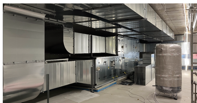
Lüftungsanlage im Untergeschoss.
